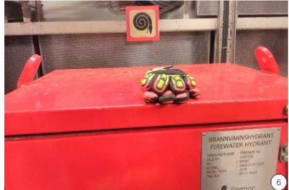
6-Etterlatte hansker i rom med lensesystemer, ved massiv vanninntrenging kan dette tette til lense systemene
