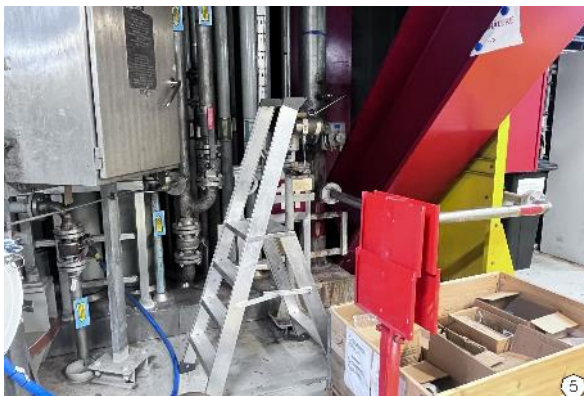
5-Utstyr sperrer ventil for brannvann.
