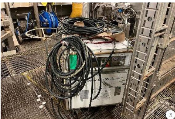
3-Usikret utstyr plassert inne i rom med vanntette dører, i verste fall kan disse komme i klem mellom døren og karmen
