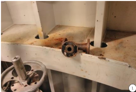
1-Løs flens kan falle ned på flottør. Det kan hindre at alarmen for vanninntrenging blir aktivisert
